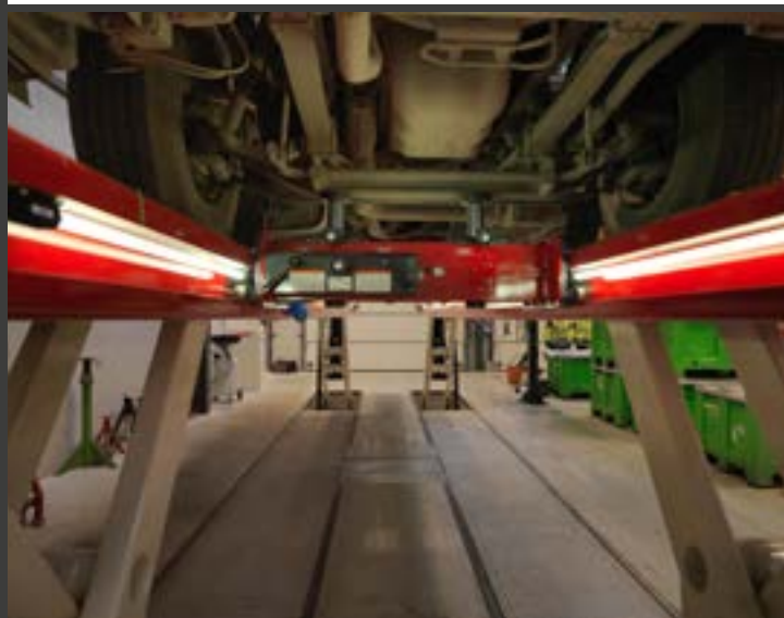
LED verlichting op laagspanning – veilig in de zijkanten van de rijbanen opgeborgen
